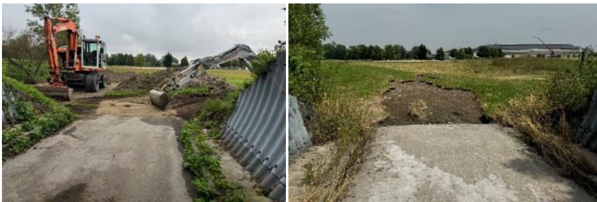
Entfernung der Aufschüttung am 26.08.2024 durch die Stadt Moosburg (linkes Bild). Durchlass Staatsstraße 2054 nach dem Hochwasser (rechtes Bild).
