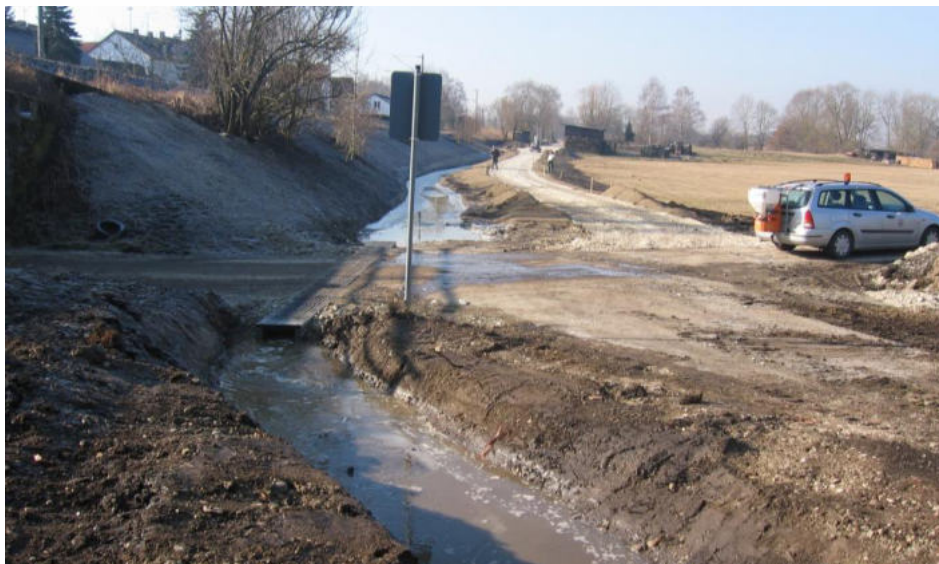
Neuanlage der Entwässerungsgräben nördlich der Bahn beim Neubau des landwirtschaftlichen Weges im Jahr 2008. Pflegearbeiten zur Freistellung des Gehölzes sind dringend notwendig.
