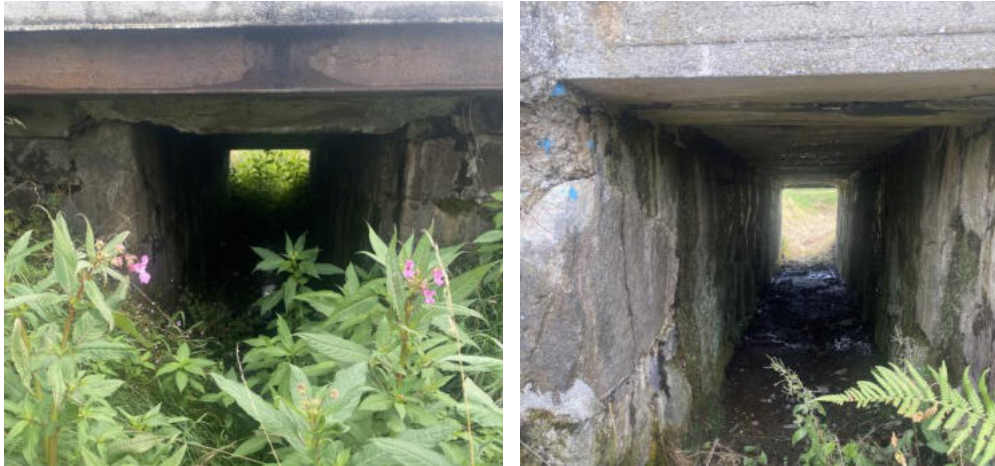
Durchlass bei km 53/2 bei der Gemarkungsgrenze zu Langenbach. Der Durchlass ist reparaturbedürftig. Die Bilder wurden 2023 von beiden Seiten der Bahnlinie aufgenommen.
